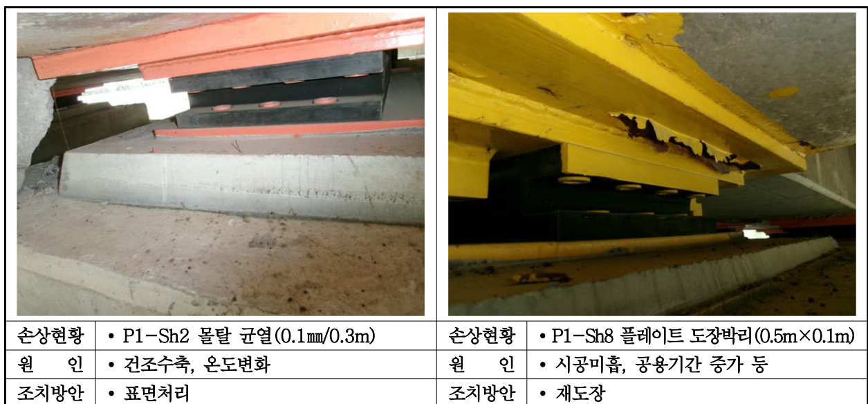
【사진 17.3.13】 교량받침 손상현황
